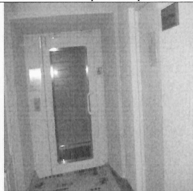
Фото 20. Подъёмник внутри здания
