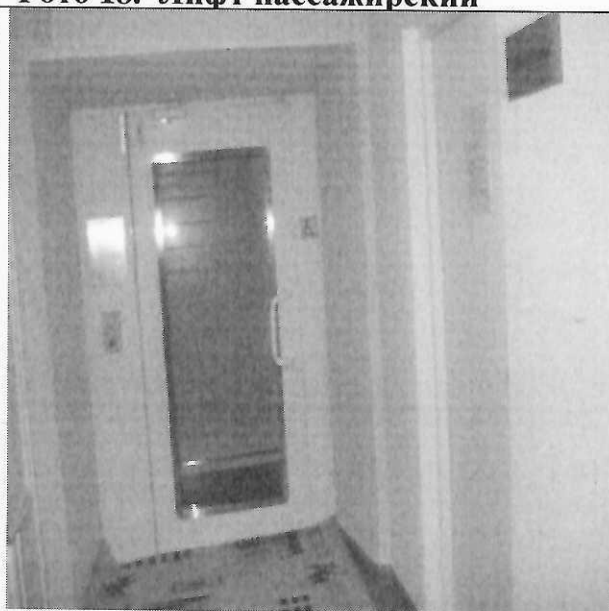
Фото 20. Подъёмник внутри здания
